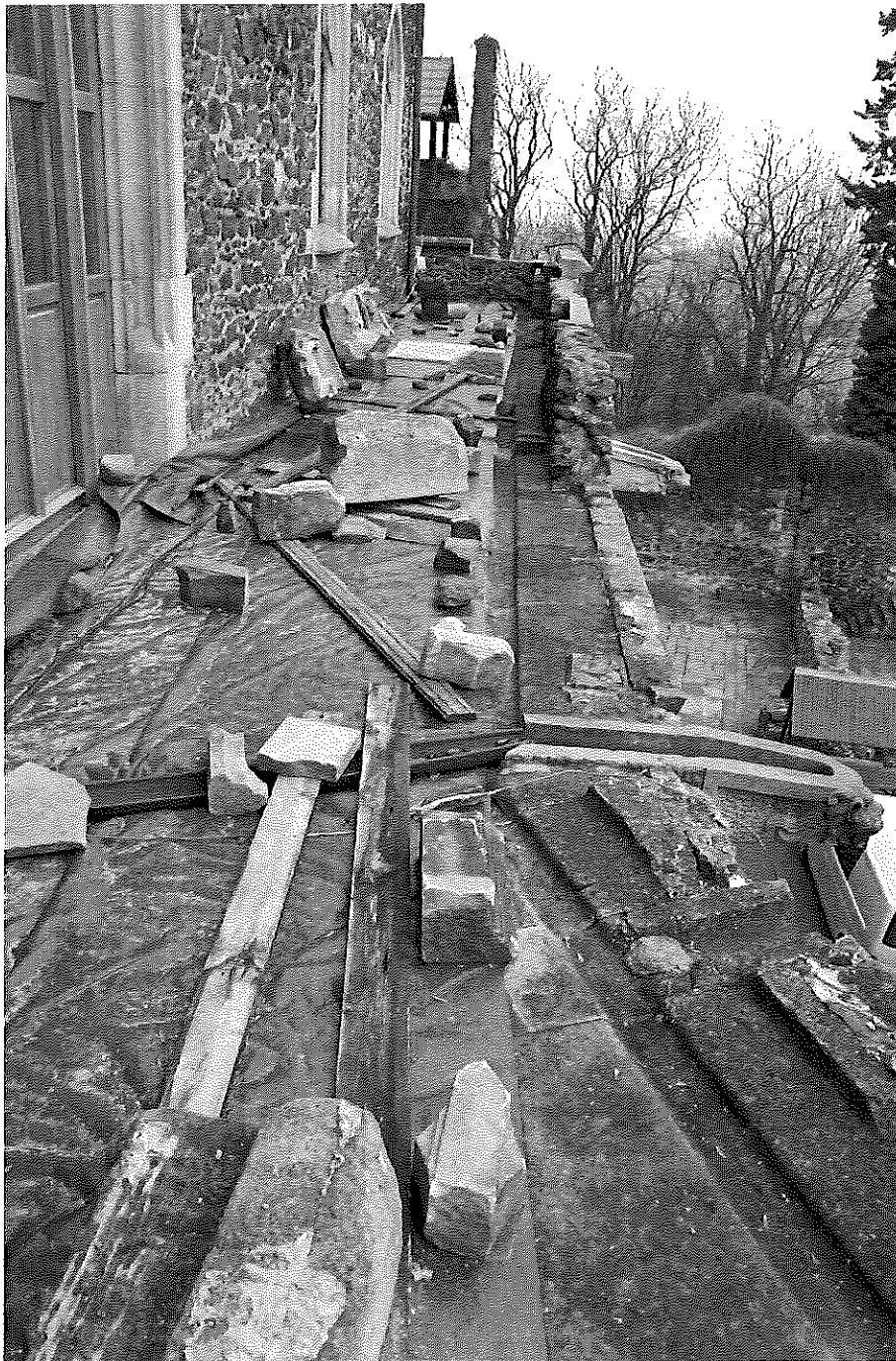
Widok tarasu w kierunku północnym. Widoczne braki balustrad i istniejący system odprowadzenia wody.
