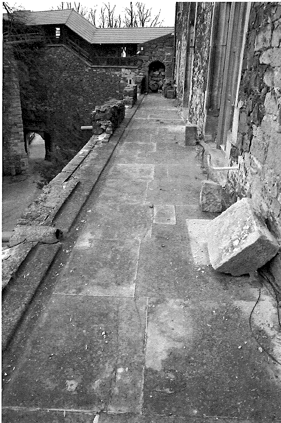
Widok tarasu w kierunku południowym. Widoczne braki balustrad i istniejący system odprowadzenia wody z utraconymi żygaczami.
