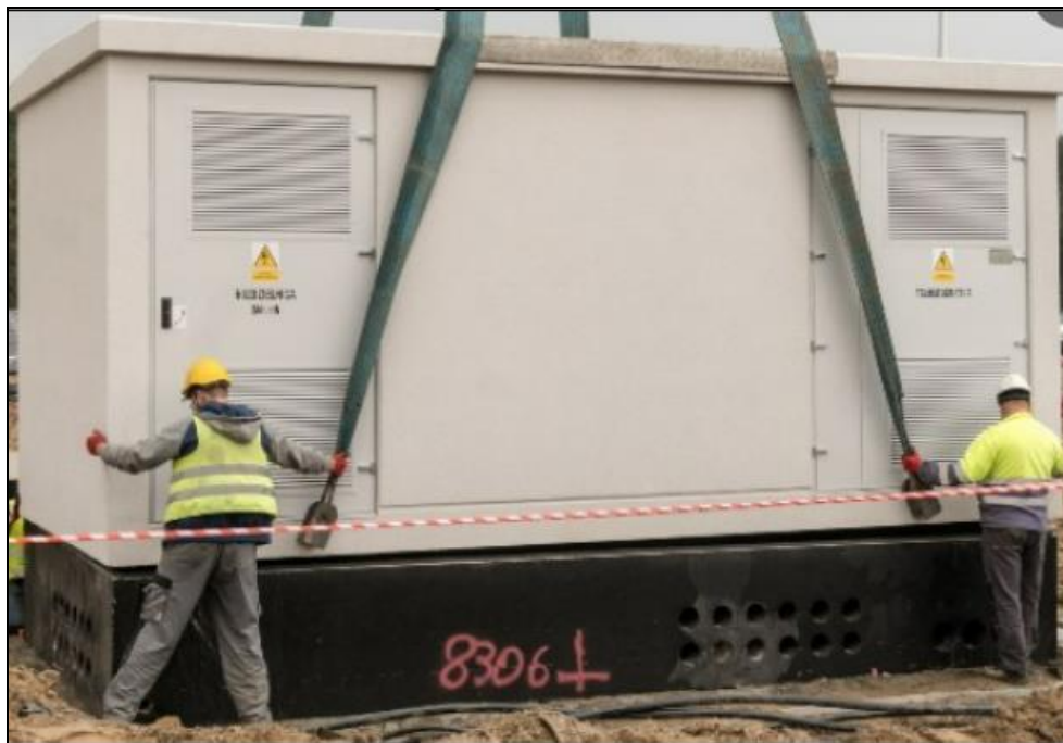
Fot. 4 Kontenerowa stacja transformatorowa nN/SN (Źródło: https://www.lm.pl )
