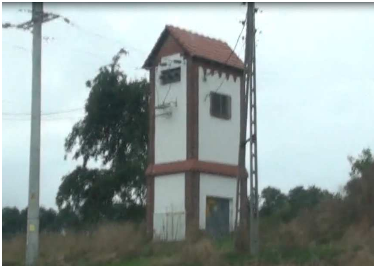
Fot. 25. Trafostacja przy drodze gminnej w Brochocinie
