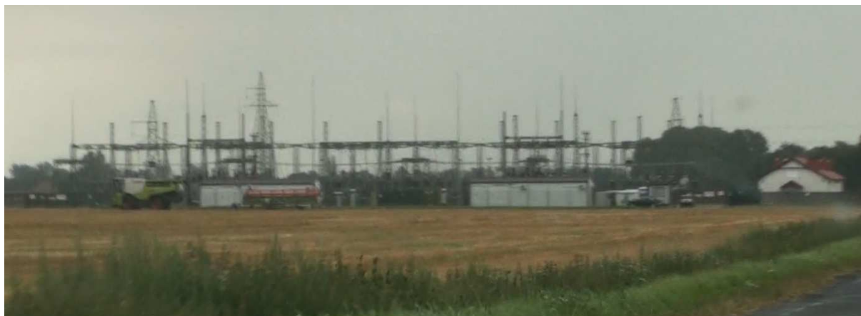
Fot.9. GPZ przy drodze powiatowej do Brochocina
