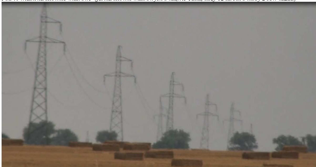
Fot.8. Linia wysokiego napięcia 110 kV
